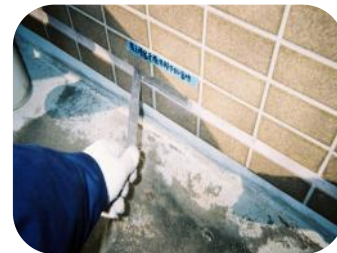
シーリング材劣化測定
